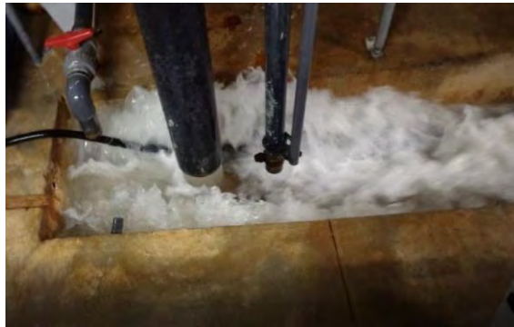
Wasseranfall bei einer Filterspülung
