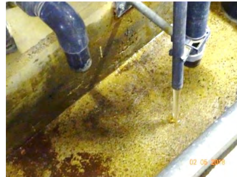
Wasserauslauf durch undichte Entlüfter
