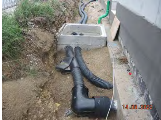
Wärmeanschluß Kinderhaus II
