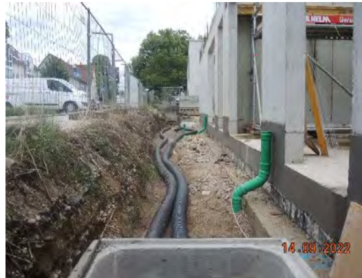
Wärmeleitung Richtung KiHa Schatzkiste
