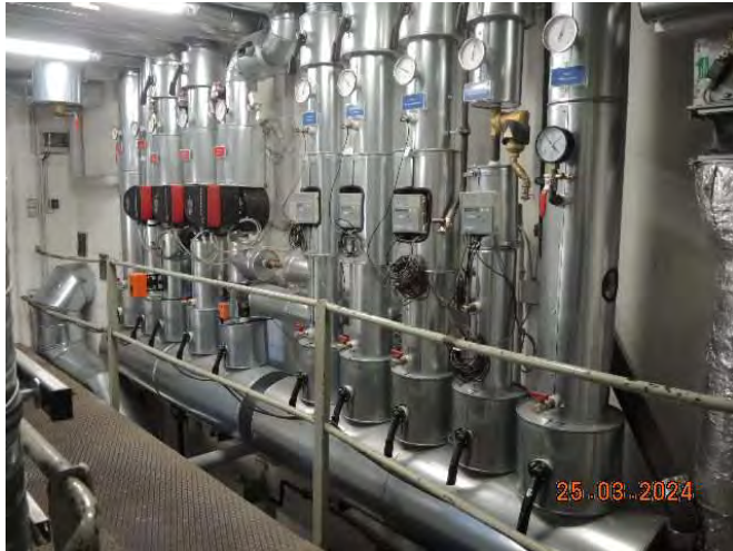
Heizungs- verteilung, obere Ebene
